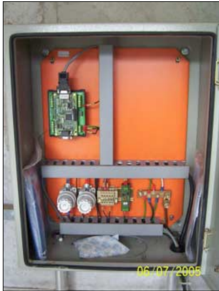
Figura 3.54 - Remota do Posto Captação Valinhos
