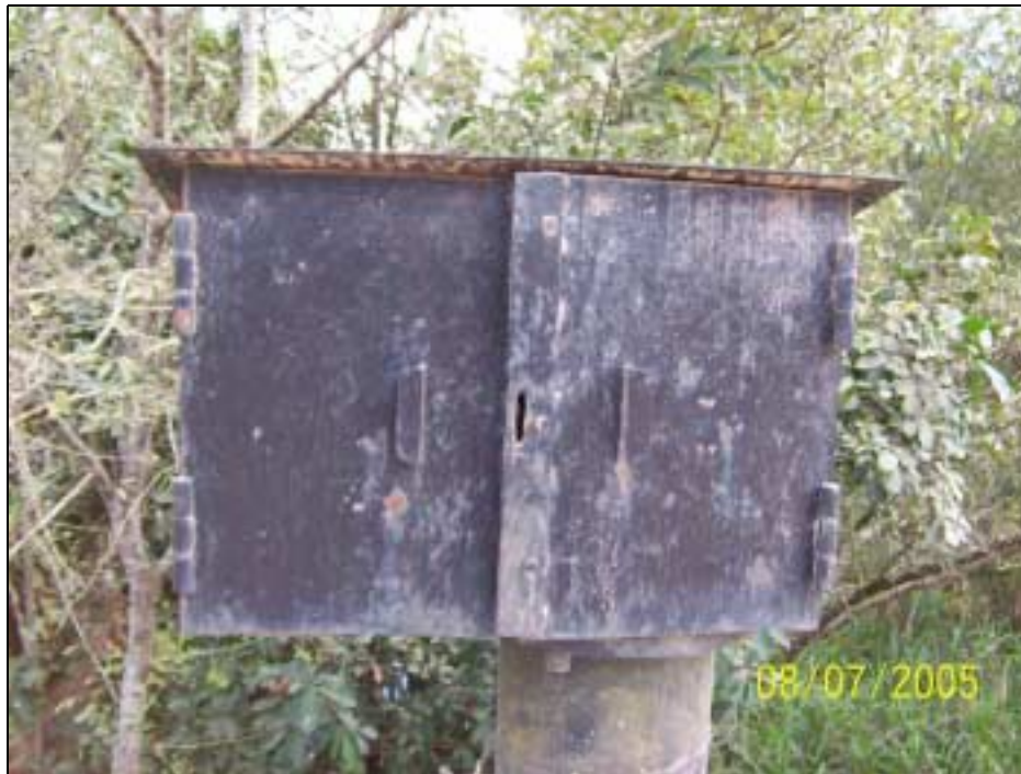
Figura 3.45 - Abrigo do Sensor de Nível
