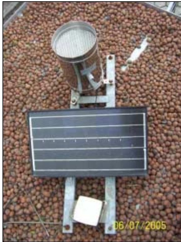
Figura 3.55 - Painel Solar e Pluviômetro do Posto Captação Valinhos
