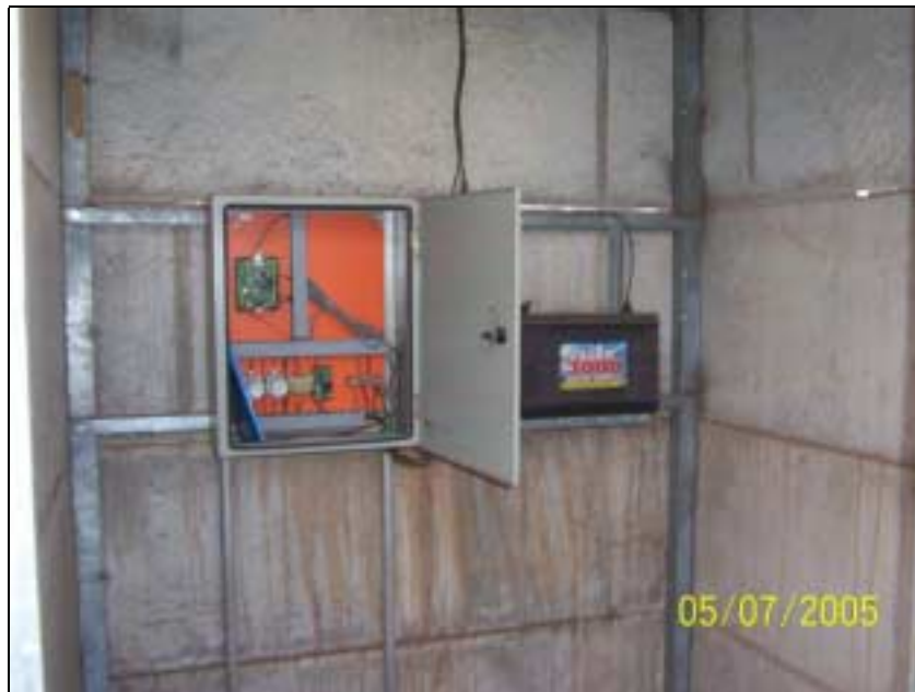
Figura 3.12 - Estação Remota do Posto Usina Ester
