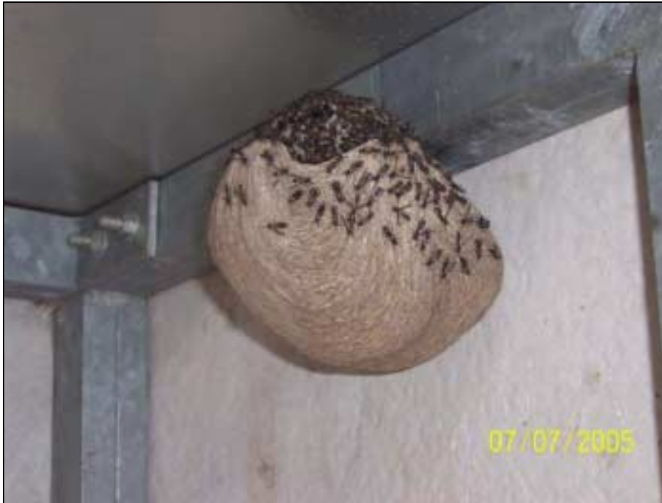
Figura 3.20 - Marimbondos dentro do Abrigo do Posto Dal'Bo
