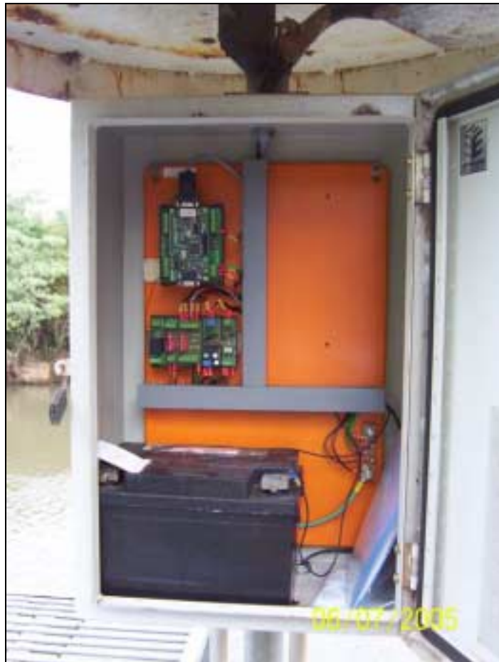
Figura 3.59 - Estação Remota do Posto Acima de Paulínia
