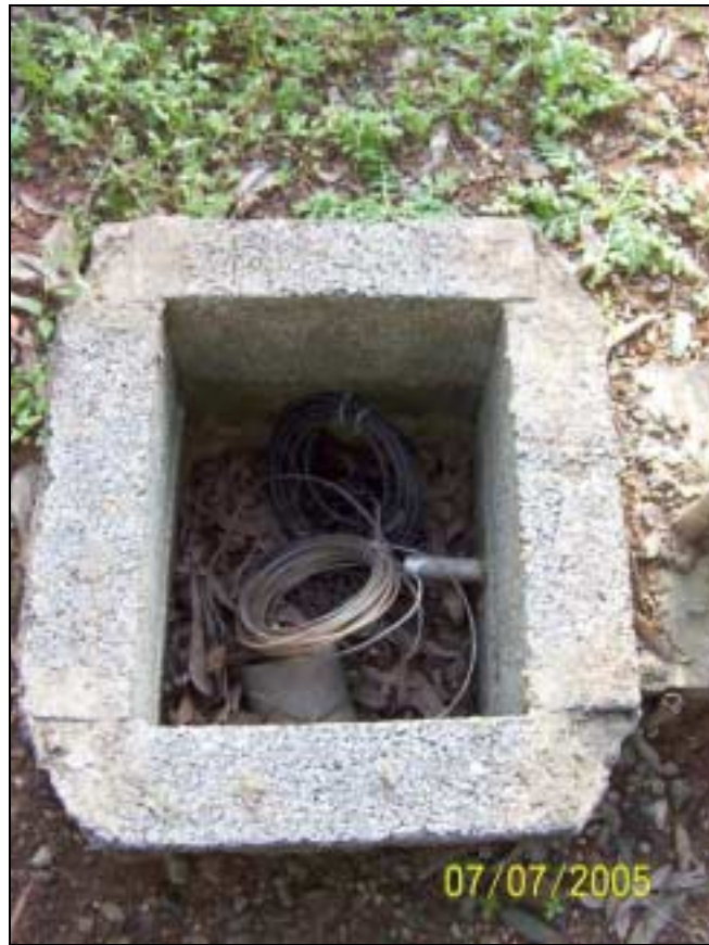
Figura 3.51 - Caixa de Passagem do Cabo do Sensor de Nível
