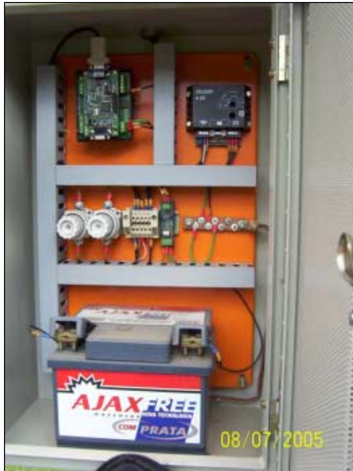
Figura 3.44 - Estação Remota do Posto Mascate
