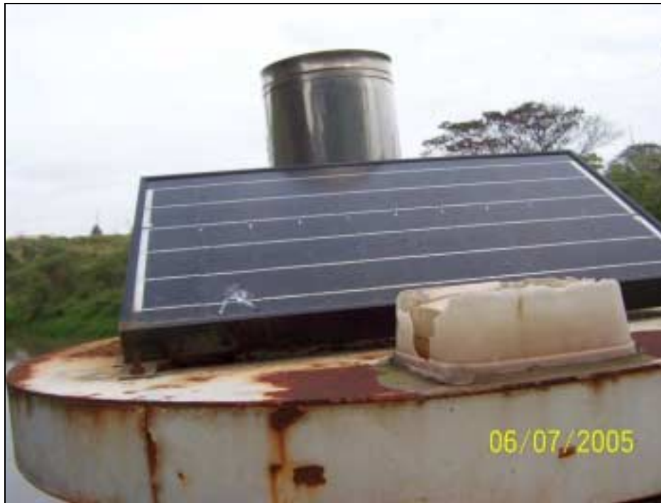
Figura 3.58 - Base do Painel Solar e Pluviômetro
