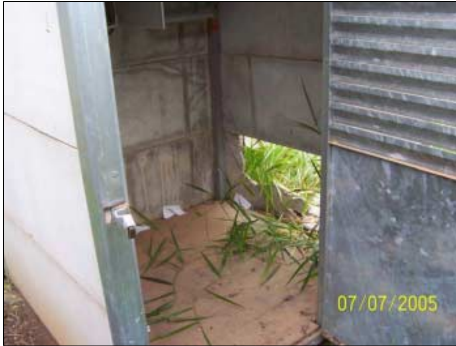
Figura 3.29 - Sinais de Vandalismo no Posto Guaripocaba
