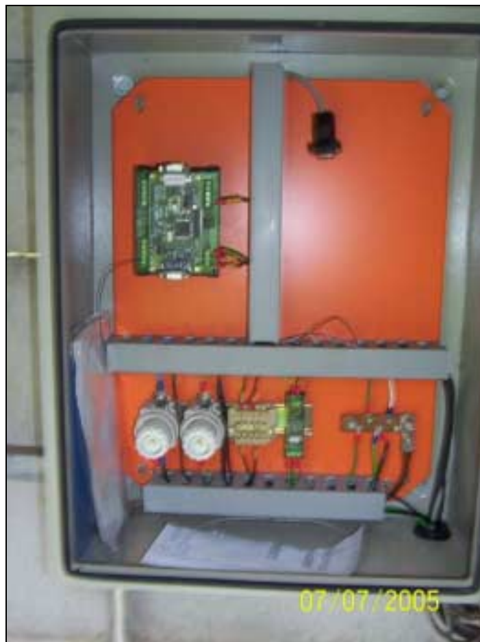
Figura 3.34 - Estação Remota do Posto Piracaia
