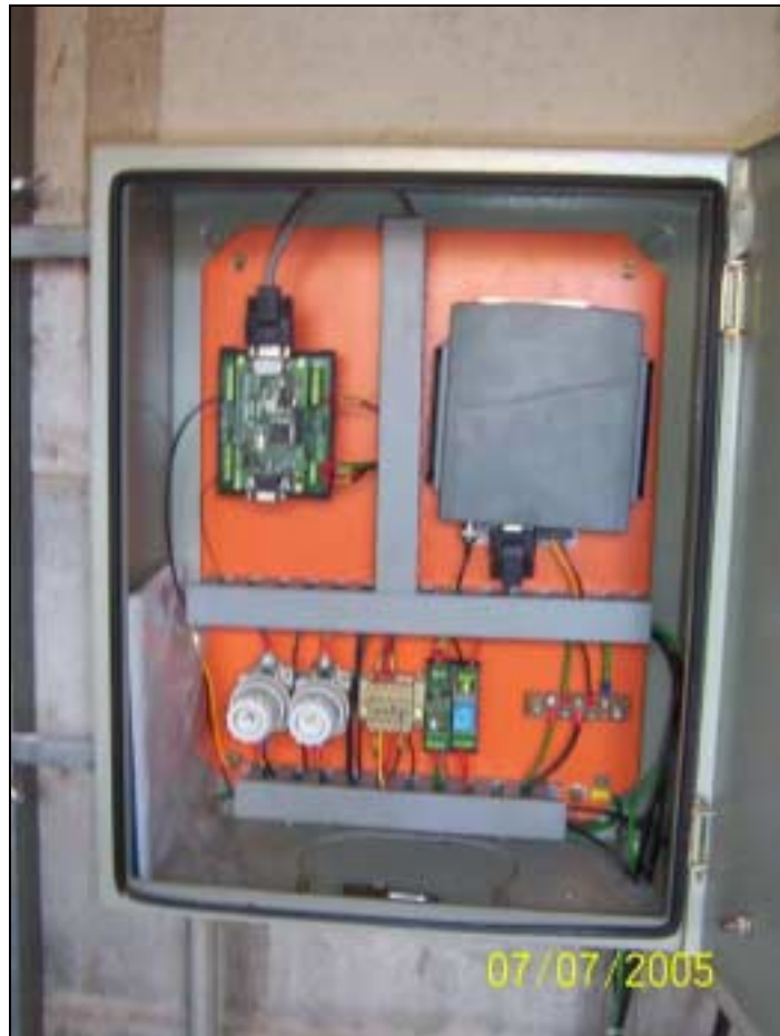
Figura 3.49 - Estação Remota do Posto Bairro da Ponte
