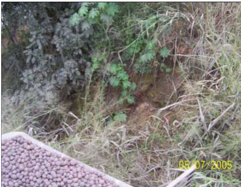
Figura 3.11 - Erosão ao Lado Posto Usina Ester
