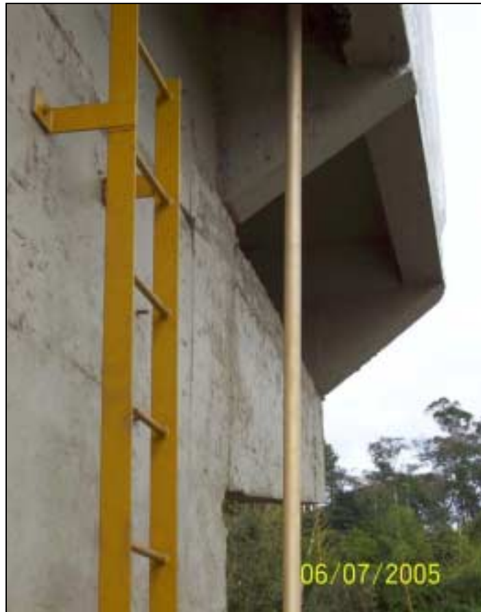
Figura 3.9 - Duto do Sensor de Nível do Posto Carioba
