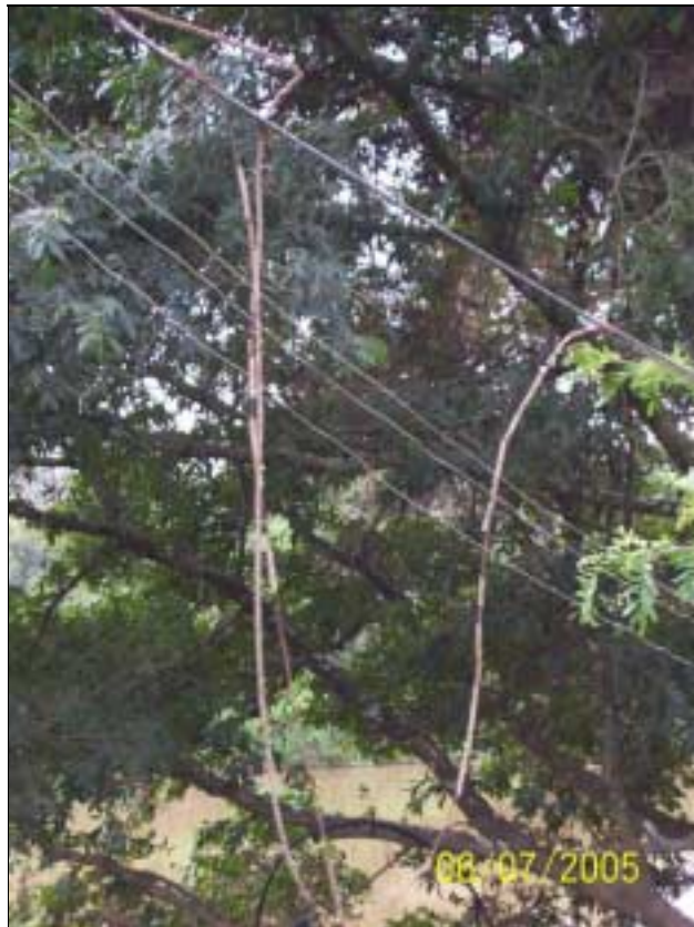
Figura 3.69 - Cabo de Sustentação do Cabo de Sinal
