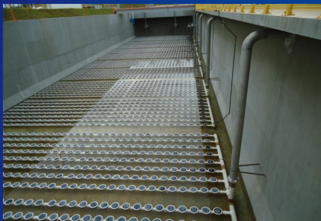
Sistema de aeração bolhas finas - 3.456 difusores
