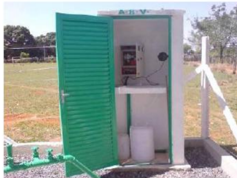
Bomba Dosadora de cloro
