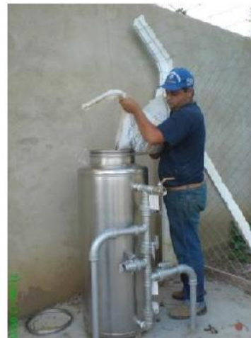
Removedor de ferro e manganês
