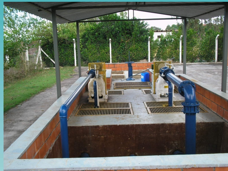
Elevatória do Jardim Brasil
