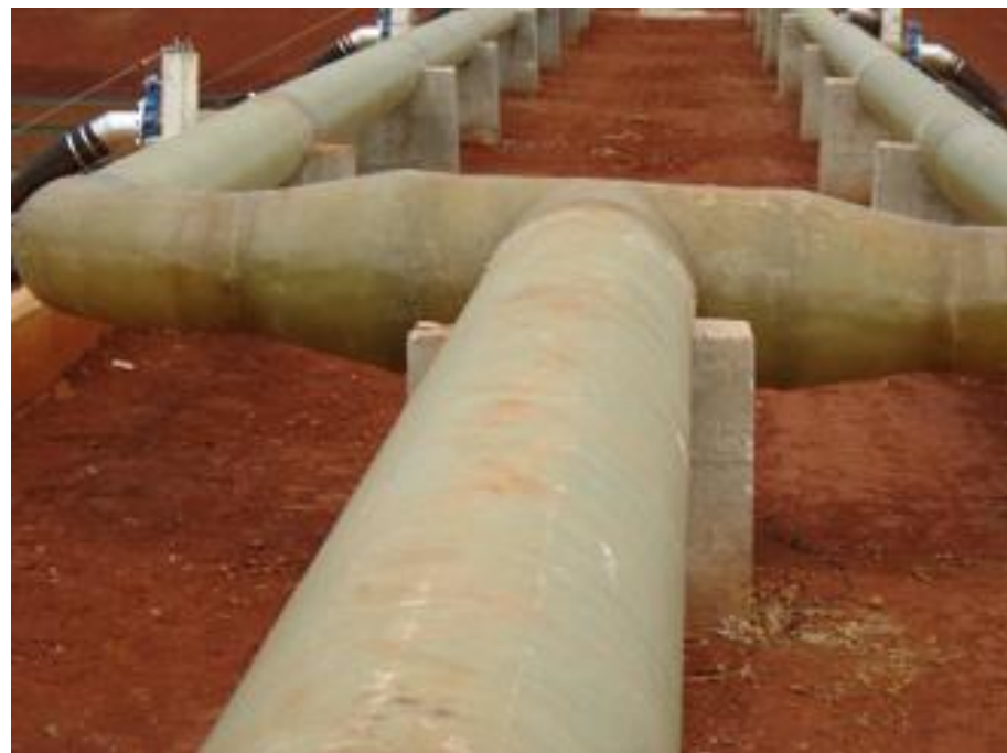
Foto 8 – Tubulação de distribuição.
