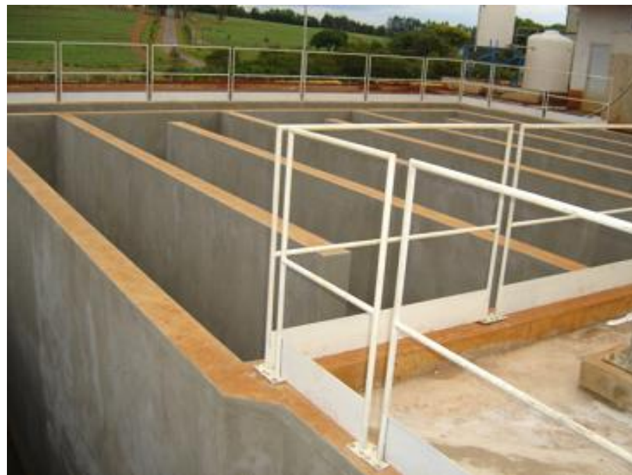
Foto 16 – Tanque de contato.
