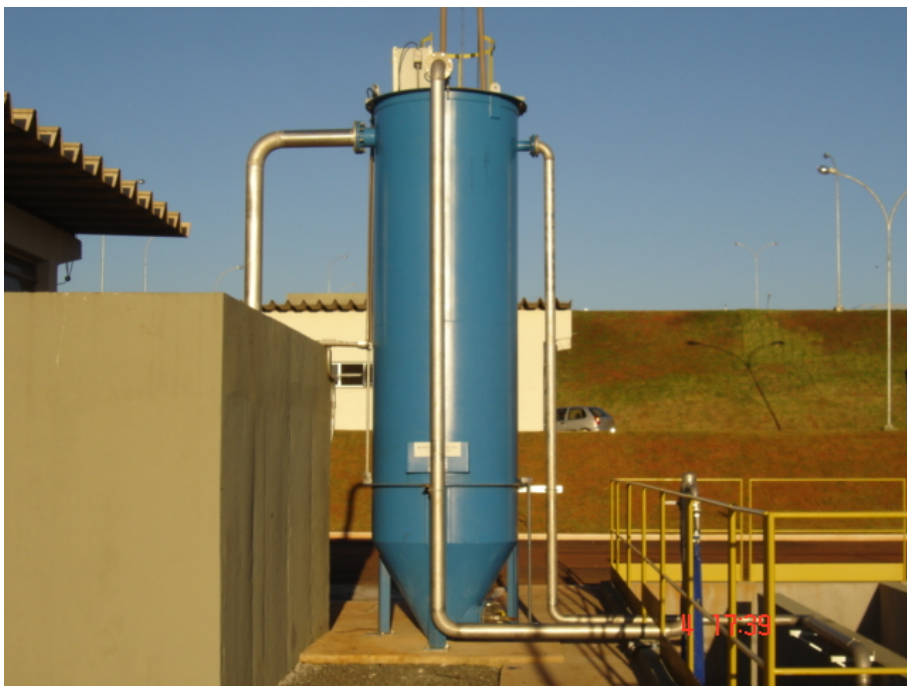
Foto 19 – Filtro de areia.
