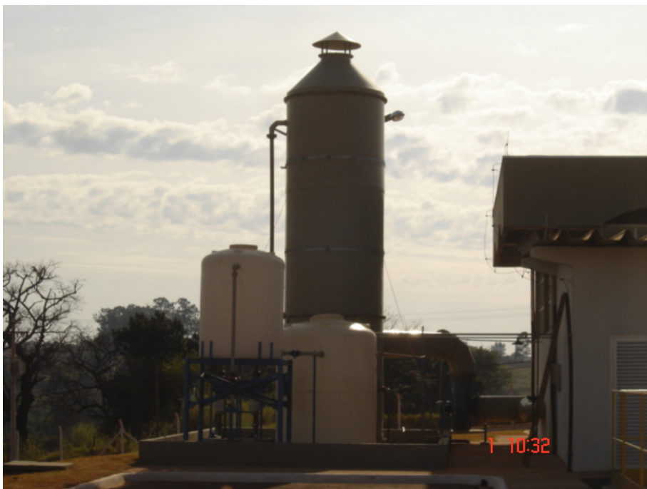
Foto 15 – Armazenamento e dosagem de cloro.
