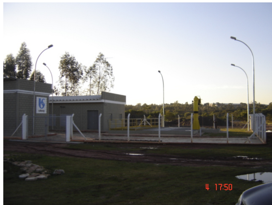
Foto 2 – Estação Elevatória de Esgotos Final.
