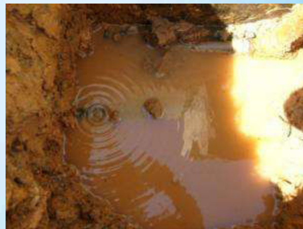
Vazamento na rede de gás ao lado do vazamento de água
