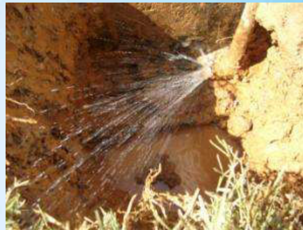
Detalhe do vazamento
