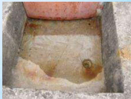
Vazamento que escorria pelo reservatório
