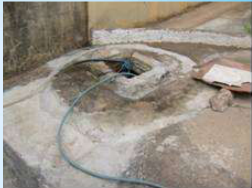
Reservatório com a “tampa improvisada” ao lado
