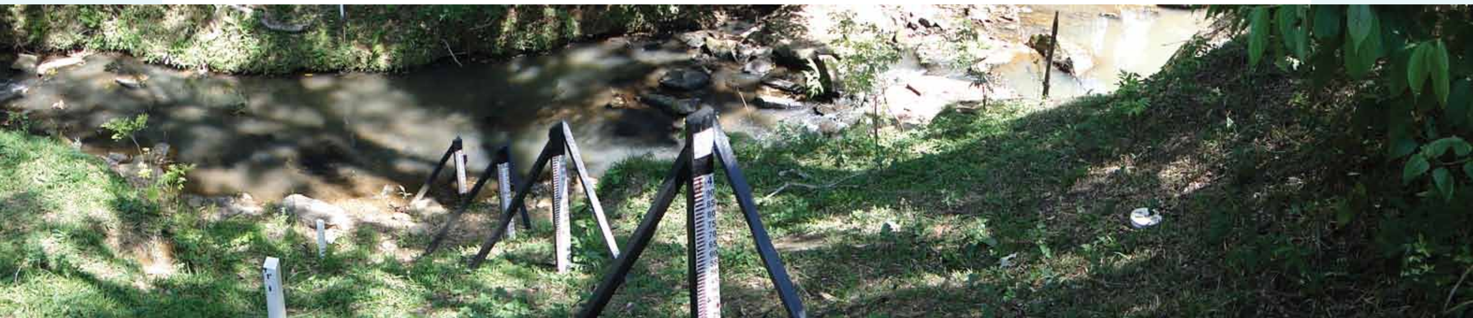
Foto 97 - Réguas de medição de vazão
