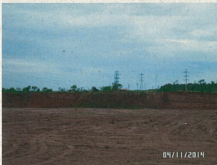
Foto 6. Vista da parte de talude onde houve a rebrota de grama. Nas áreas e nas partes de taludes onde não houveram a rebrota, os mesmos serão semeados de grama.
