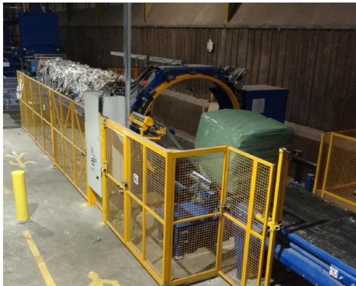
Figura 7.4.1.3-1 - Prensa compactadora e envelopadora.
